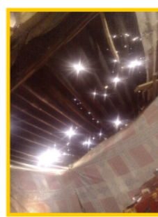
Trous dans les toits des maisons
